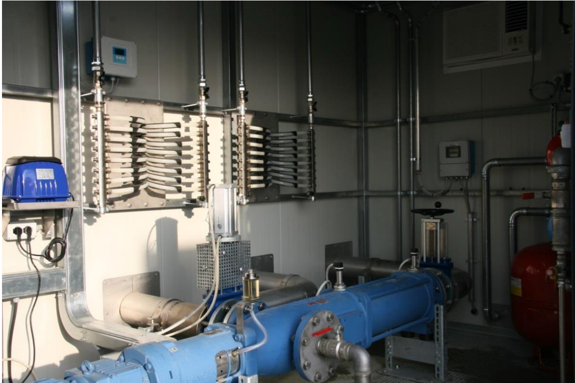
Sistema de calefacción de biodigestor
