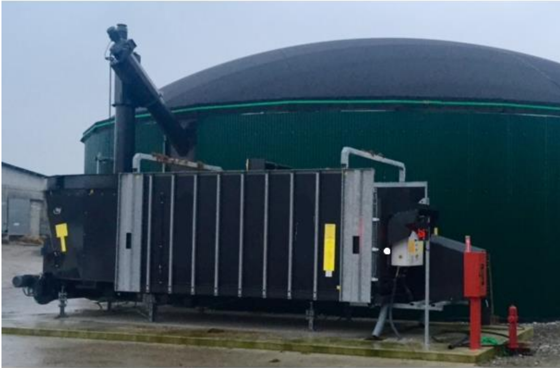
Ejemplo de tolva de carga de materias sólidas
