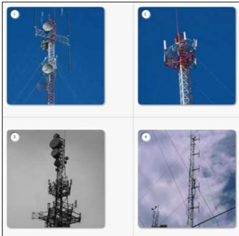
Fig. 35- Distintas estructuras con diversos sistemas de antenas.
