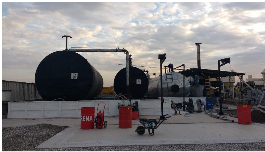
Foto 3 – Parque de tanques de fuel-oil y asfalto.
