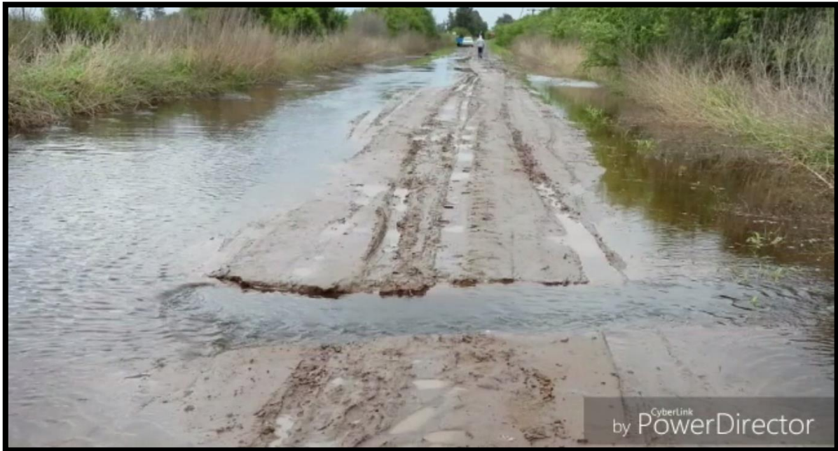
Figura n°4: Estado del camino rural en la localidad de La Carlota
