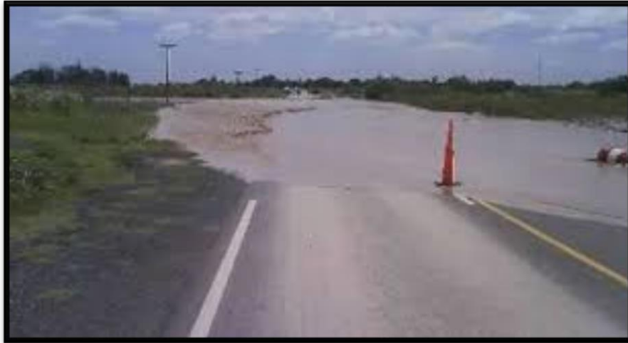
Figura n°2: Inundación sobre la Ruta Nacional N° 8
