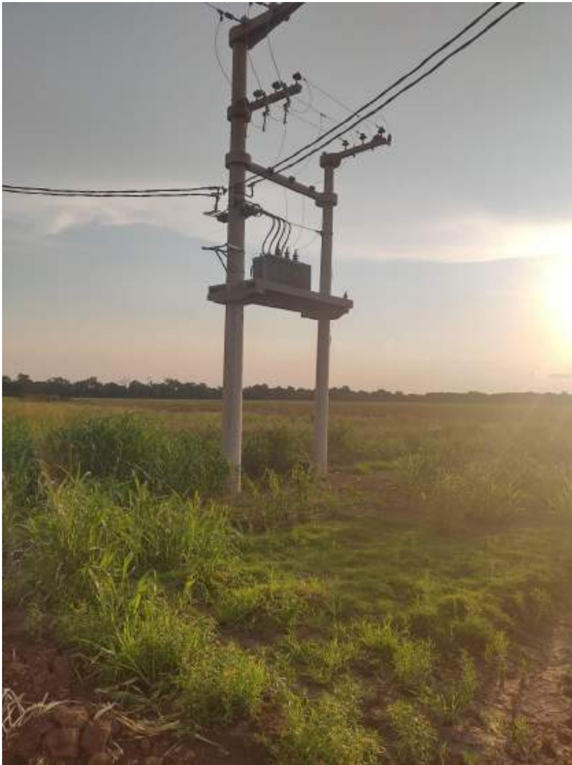
Figura 2. Foto de la subestación transformadora instalada en el loteo.
