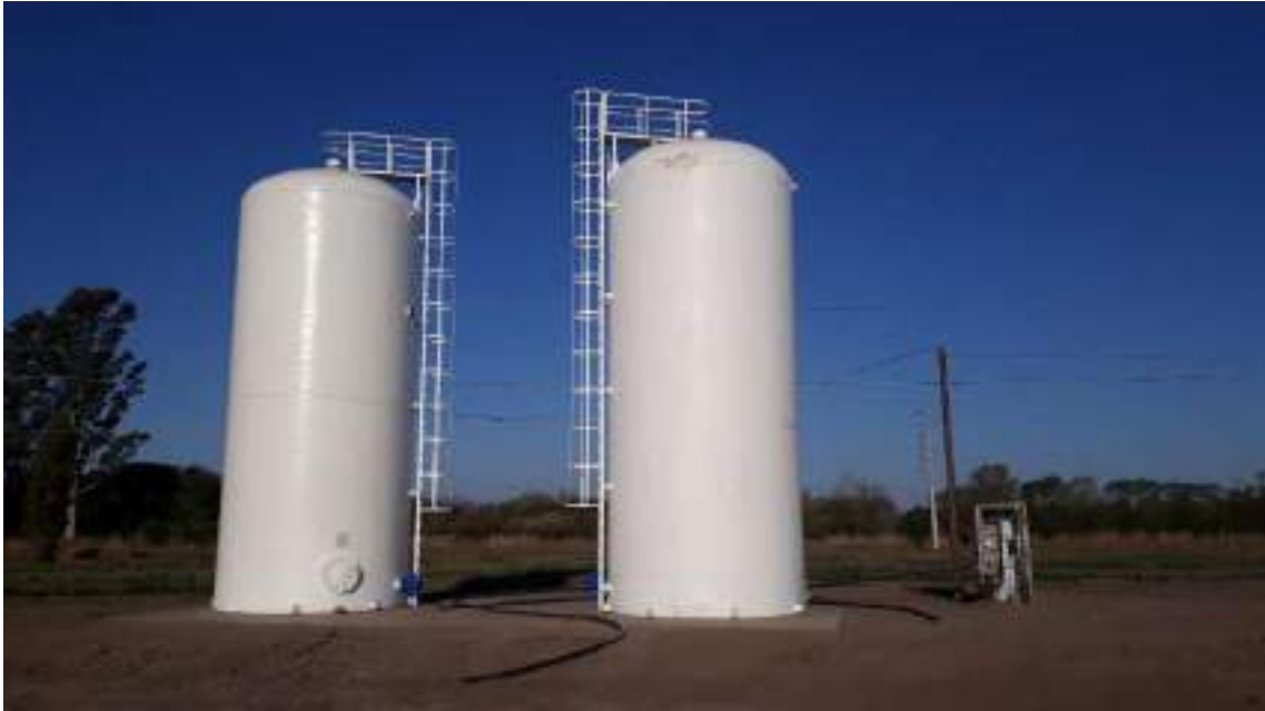
Fotografía n° 7. Tanque depósito de agua y a su costado perforación extractora.
