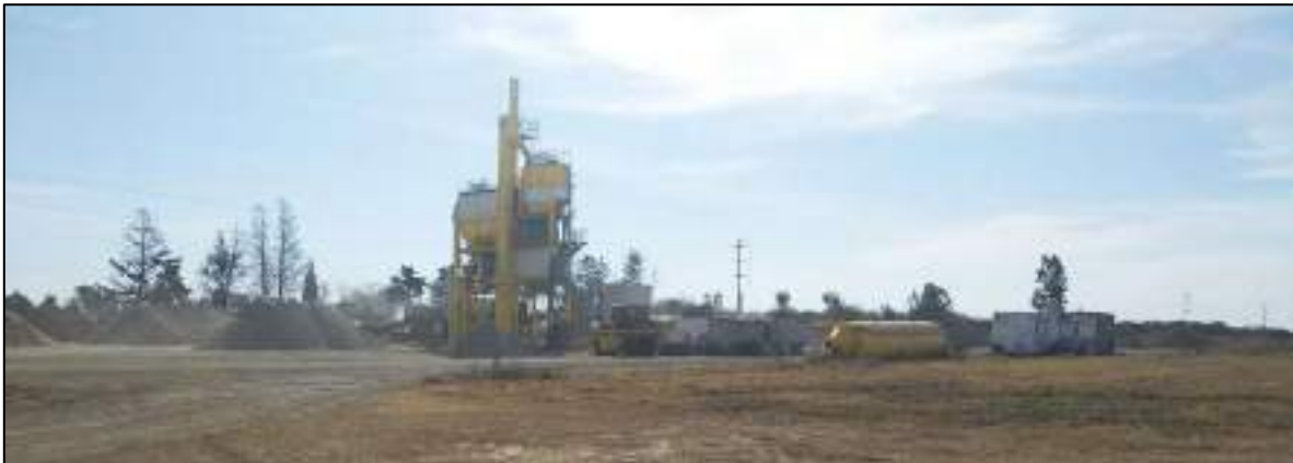
Imagen N° 5. Fotografía mostrando las instalaciones de la Constructora APE S.A. en el ingreso al predio donde funcionará el Loteo Parque Industrial y Tecnológico. Extremo sur del loteo.
