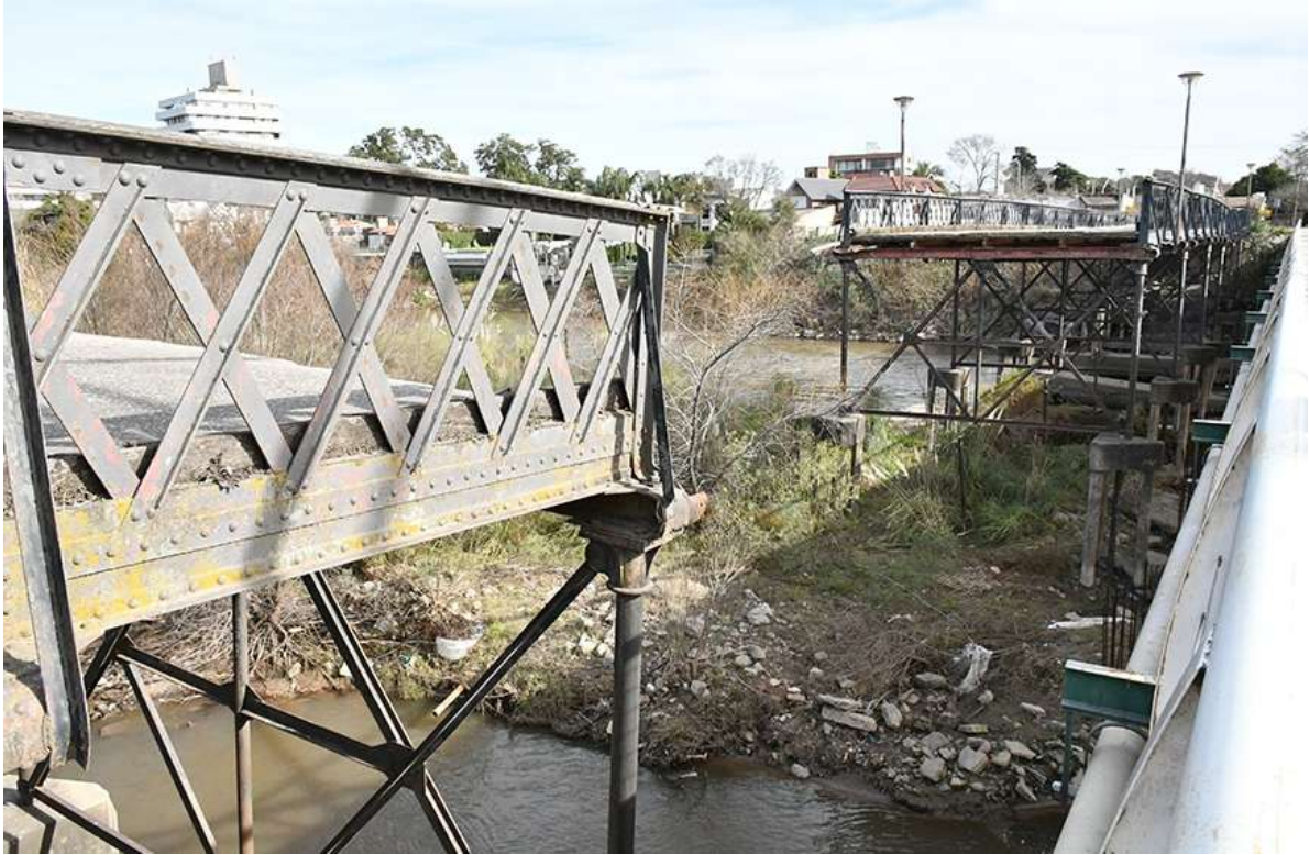
Figura 9: tramo afectado del ex puente Vélez Sarsfield (El Diario, 18/08/2025).
